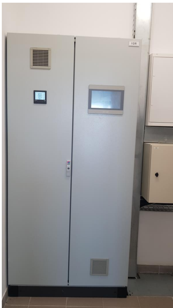
Rys. 2.5. Rozdzielnia wraz z aparaturą sterowania elektrycznego urządzeń OS Mostkowo
