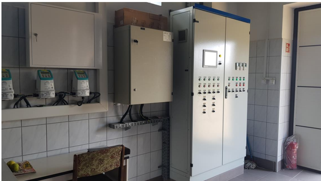
Rys. 2.7. Rozdzielnia oraz urządzenia zasilania i sterowania elektrycznego urządzeń SUW Mostkowo
